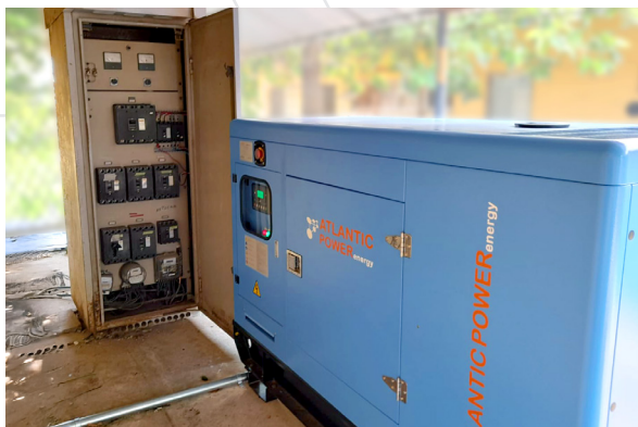
▲ Ilustración 1: Instalación final del Grupo Electrónico
