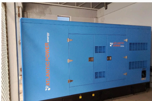
Fig. 2. Instalación del Grupo Electrónico a su ubicación final
