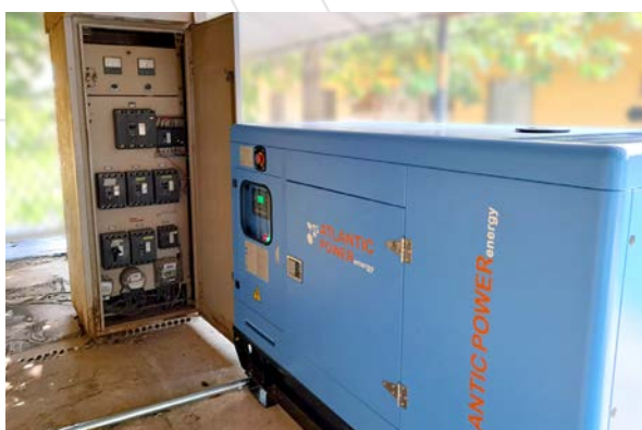
▲ Ilustración 1: Instalación final del Grupo Electrónico
