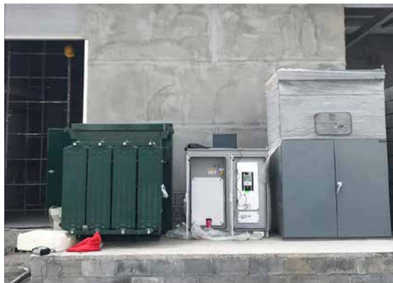
▲ NOJA Power GMK-1000 en instalación en una zona industrial.
