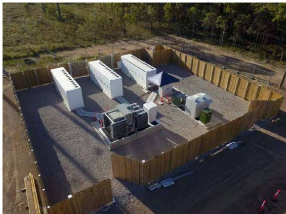
▲ Imagen del BESS localizado en Black River, Queensland Australia, cortesía de Yurika
