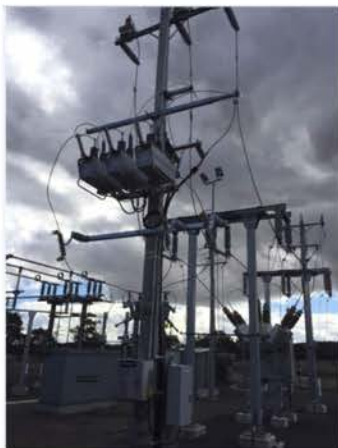
Figura 4: Reconectador Mono-Tripolar utilizado para la conexión a tierra de la Fase de Falla en una Subestación en Australia
